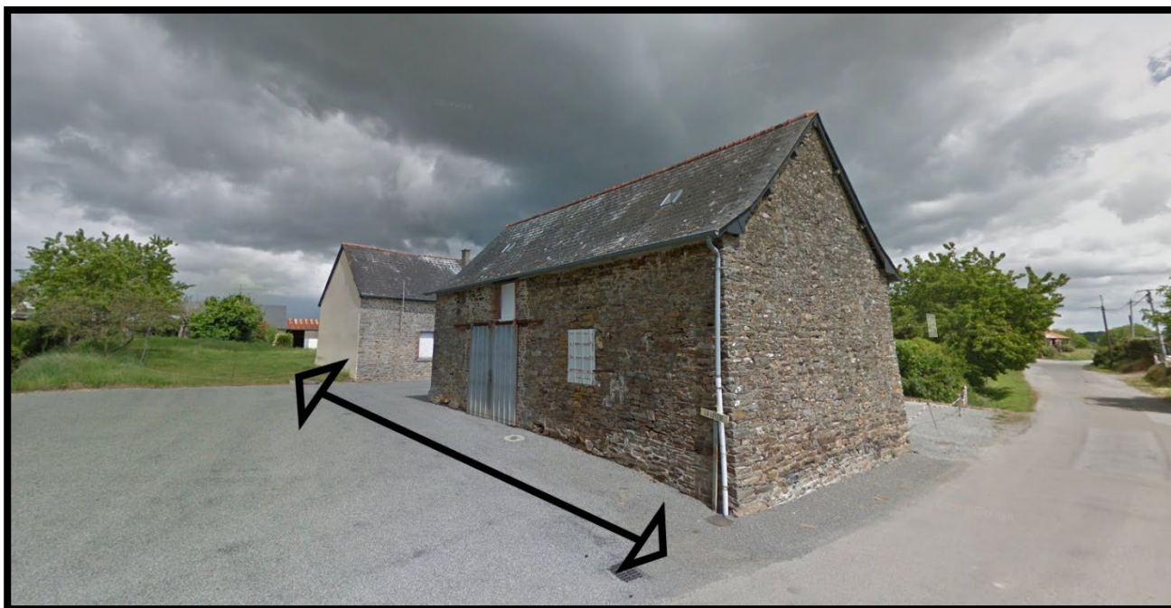
Principe d'accès à supprimer (le plus à l'ouest figurant dans l'OAP et posant un problème de visibilité routière)
